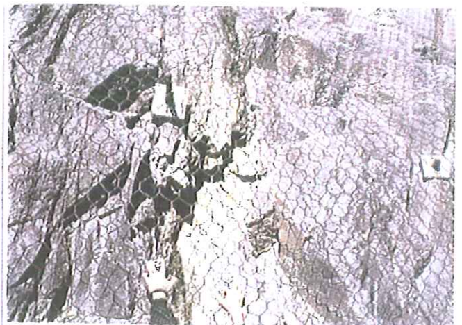
b) détail des têtes d'ancrages ; le grillage pendu n'est pas lié aux plaques d'ancrages.
