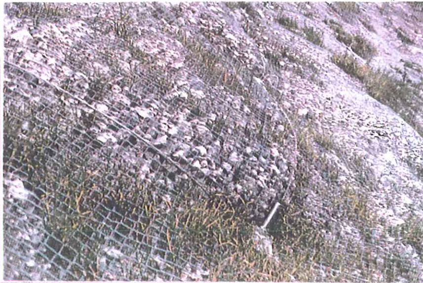
Fig. 1 - Nappe de grillage ancrée sur talus d'éboulis. On observe que des poches de cailloux, pouvant entraîner à terme une rupture du grillage, se forment en raison d'un placage insuffisant.
